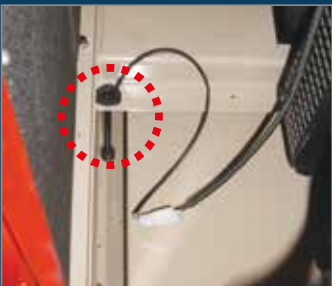
▲ Alarma con tanque de retención
