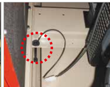
▲ Alarma con tanque de retención
