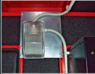
▲ Sistema de iluminación interno
