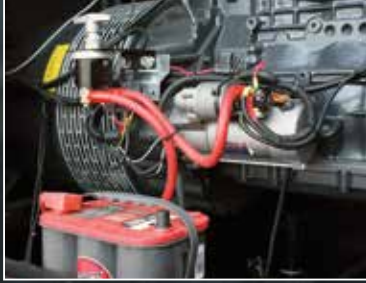
▲ Batería libre de mantenimiento
