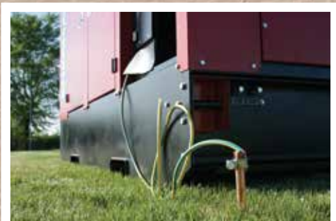
◀ Varilla de puesta a tierra
