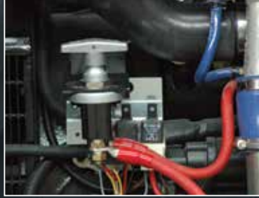
▲ Switch aislador de batería
